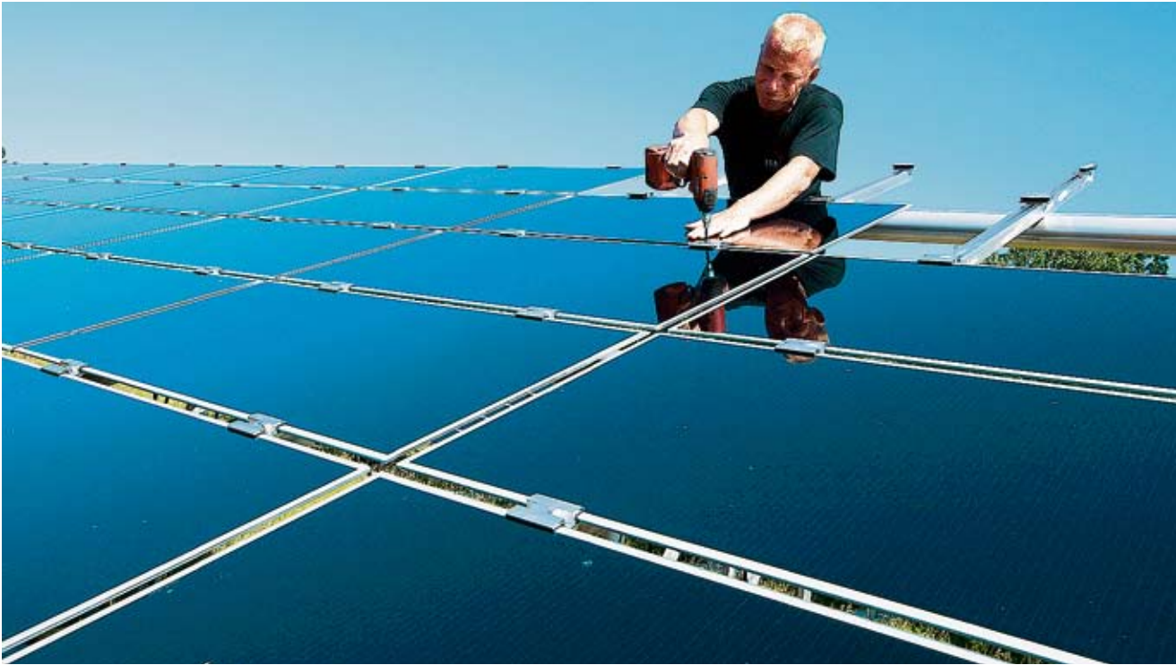
Berlins größte Solaranlage steht auf dem Gelände des Wasserwerks Tegel
