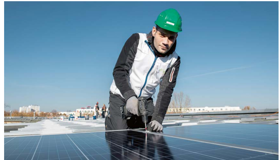
Seit 2016 wurden mehr als ein Drittel aller auf Berlins Dächern gebauten PV-Anlagen von den Berliner Stadtwerken installiert.
