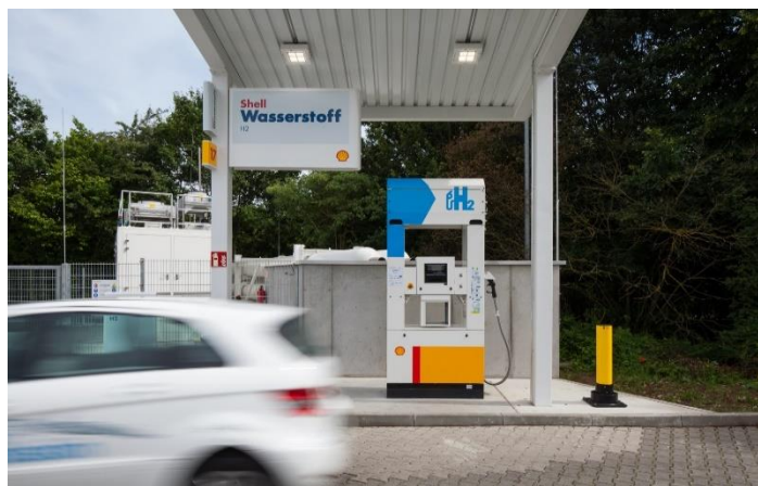
Abbildung 11: Wasserstoff-Tankstelle der H2Mobility [51]
